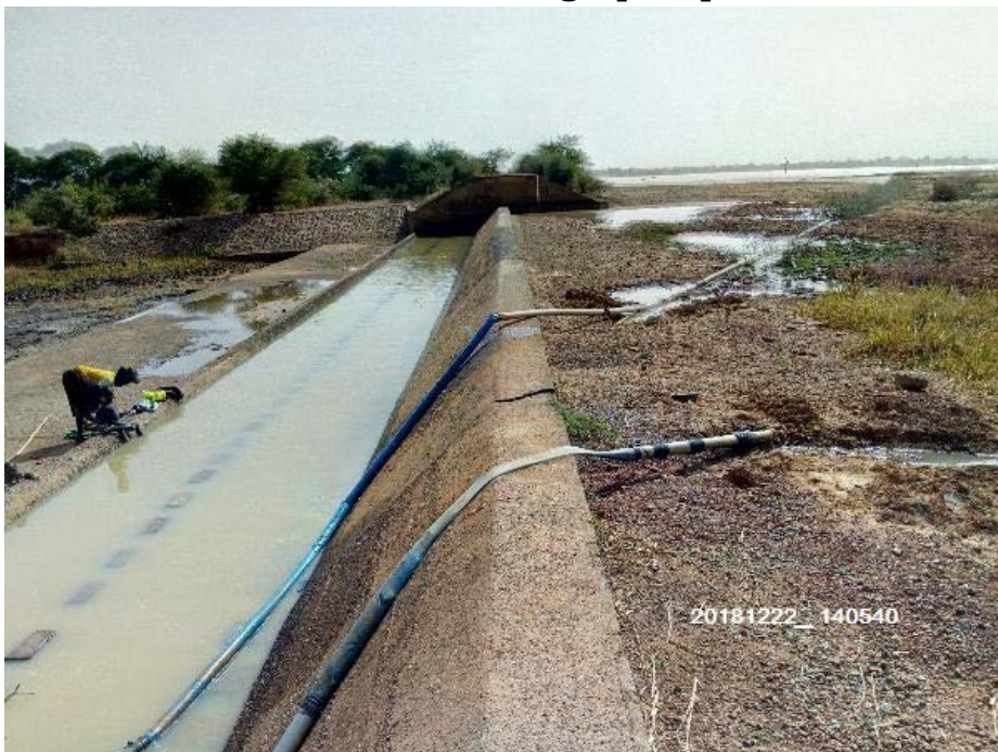
Photo 9 : Vu du déversoir du barrage qui a perdu sa hauteur
