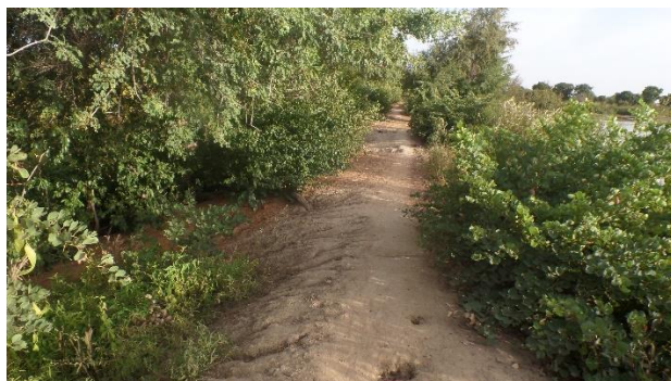
Photo 1 : Talus du barrage de Koulofo envahi d'arbustes
