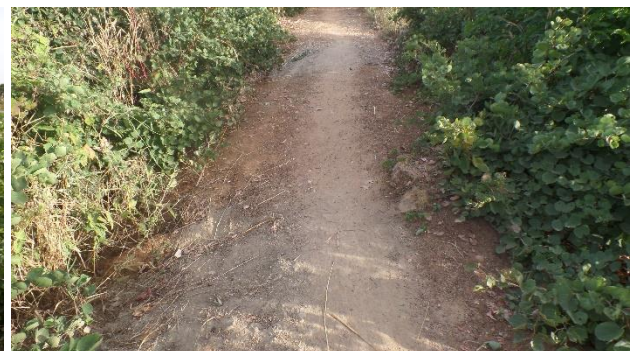
Photo 2 : Travaux de réparation en gris réalisés sur la digue par les usagers du périmètre
